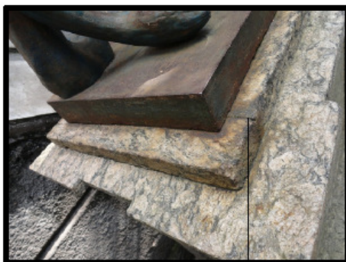
IMAGEM 2 MANCHA DE OXIDAÇÃO SOBRE A BASE
