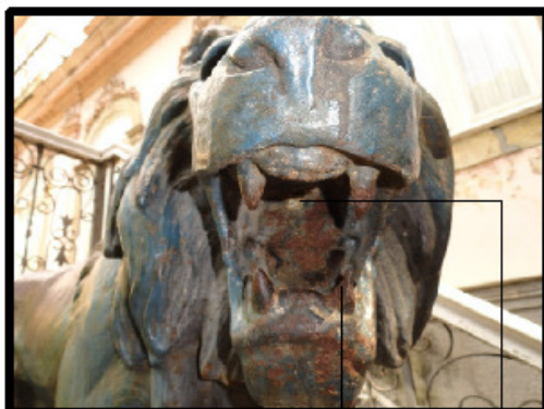
IMAGEM 1 INTENSA OXIDAÇÃO DESGASTE DOS DENTES PROVOCADO PELAS ÁGUAS PLUVIAIS
